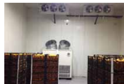
Μεταφερόμενη συσκευή με αυτόνομο σύστημα δυναμικού αποπρασινισμού τοποθετημένη σε ψυκτικό θάλαμο σε πλήρη λειτουργία.
