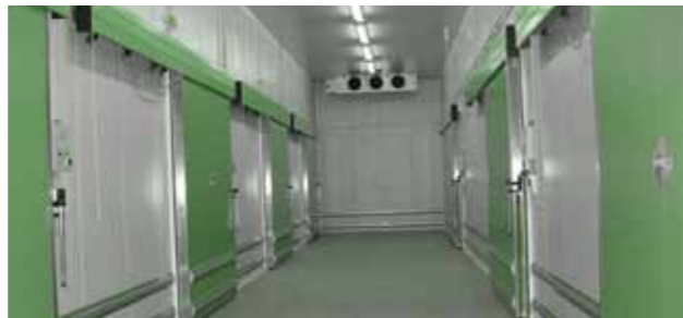
Ψυκτικοί θάλαμοι και ψυκόμενος διάδρομος.
