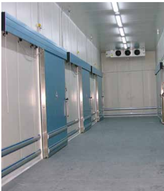
Ψυκτικοί θάλαμοι και ψυχόμενος διάδρομος.
