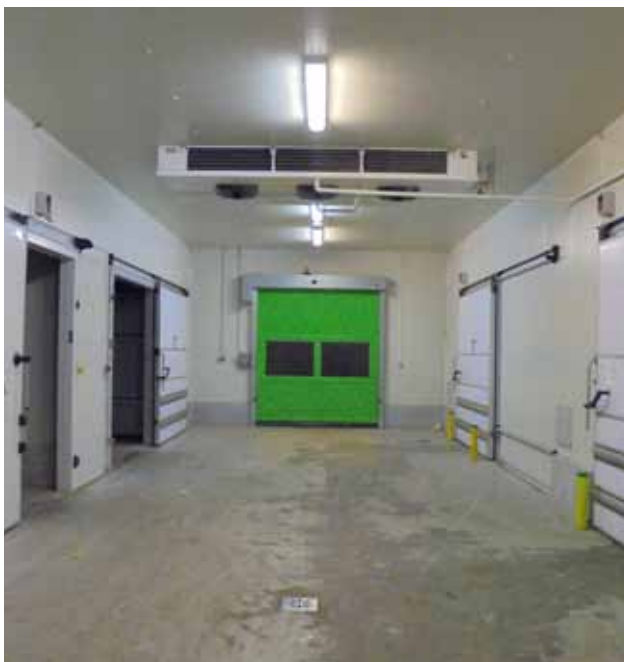
Ψυκτικοί θάλαμοι και ψυχόμενος διάδρομος
