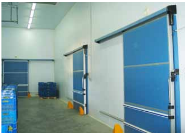
Ψυκτικοί θάλαμοι και ψυχόμενος διάδρομος.
