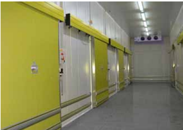
Ψυκτικοί θάλαμοι και ψυχόμενος διάδρομος.
