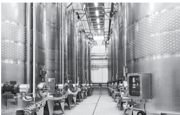
Δεξαμενές εξωτερικού μανδύα
