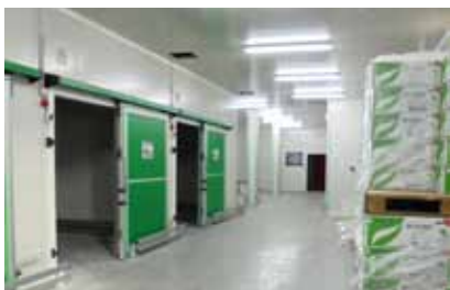
Ψυκτικοί θάλαμοι και ψυχόμενος διάδρομος αποστολής προϊόντων.
