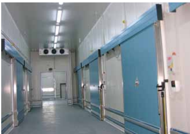
Ψυκτικοί θάλαμοι και ψυχόμενος διάδρομος.
