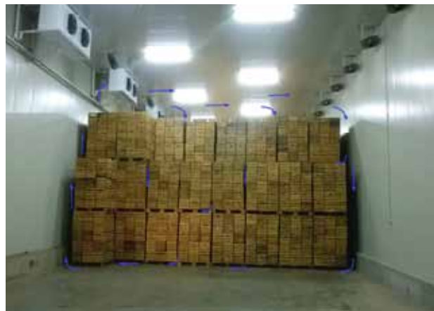
Ψυκτικός θάλαμος αποθήκευσης σκόρδων.
