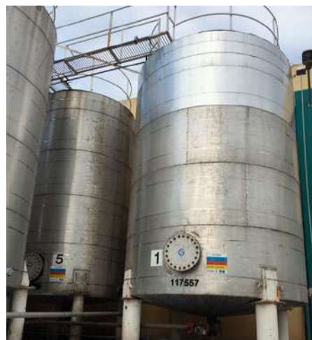
Δεξαμενές α' υλών, βάσης νερού. Εκτός από την ανθρωποθυρίδα μπροστά, υπάρχει και δεύτερη στην κορυφή των δεξαμενών
