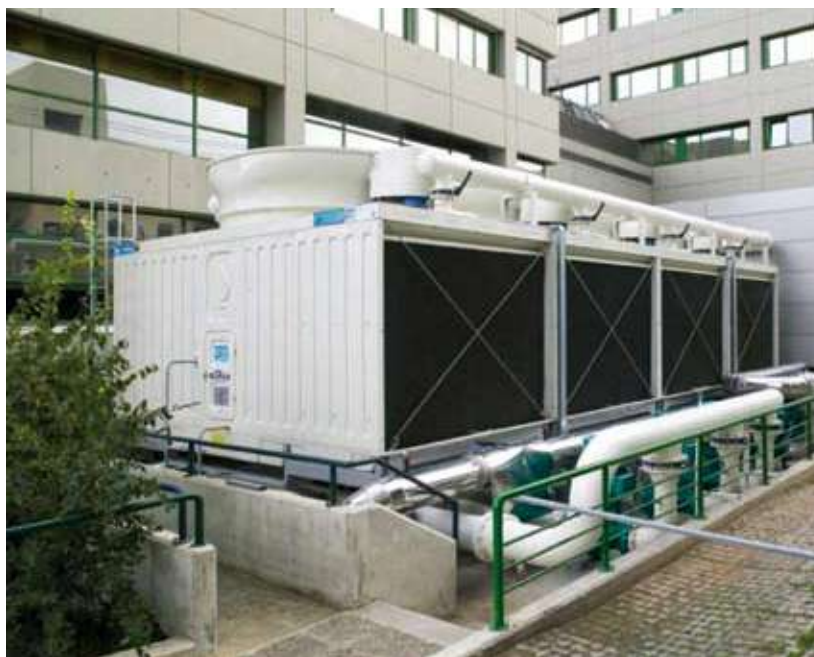
Φωτ. 2: Πύργοι Ψύξης Μονάδος Κλιματισμού με Ψύκτες Απορρόφησης
